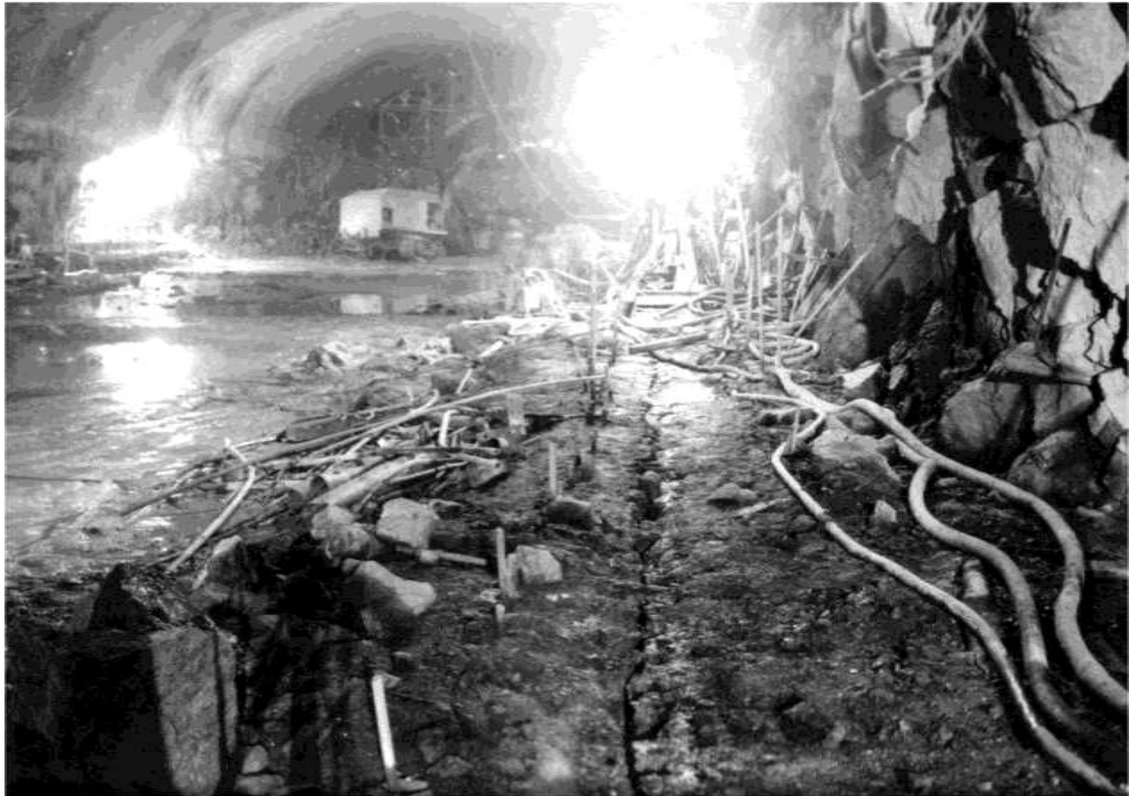
Рисунок 37 – Загальний вигляд підсклепінного простору Колимської ГЕС (Росія) і утворена методом гладкого підривання щілина
